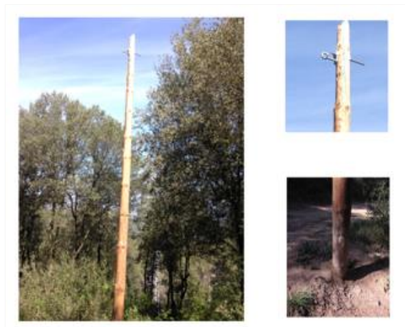
Il·lustració 6. Detalls dels pals de fusta a substituir (Font: Telefònica d'Espanya. Any 2021)
