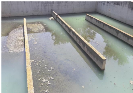
Figura 2. Dipòsit decantador Conclusions
