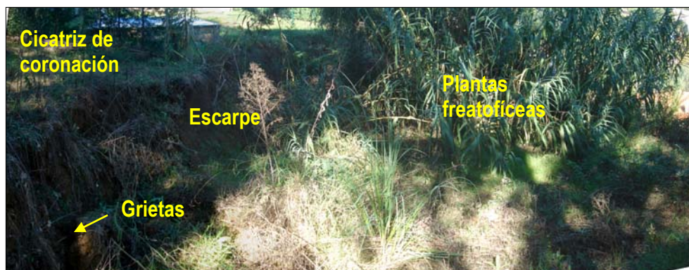
Fig.13. Panorámica de la cicatriz de coronación y de la plataforma de rotación.
