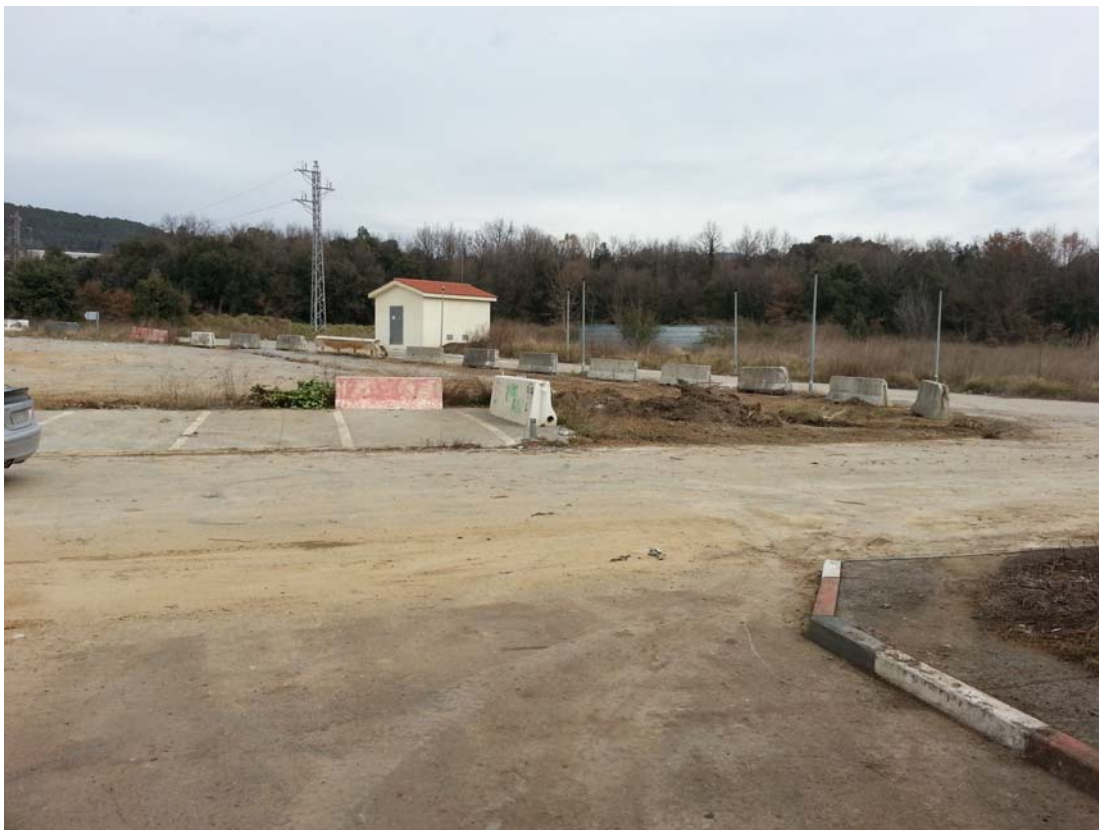
Vista estació transformadora i accés.
