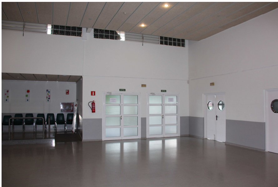
FOTO 14.-Entrada sala amb sistemes de protecció.
