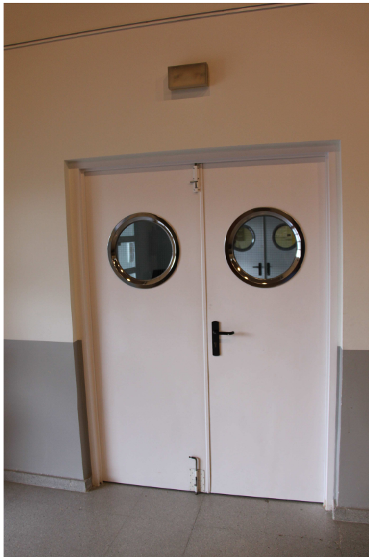
FOTO 16.-Portes de sectorització metàl·liques.
