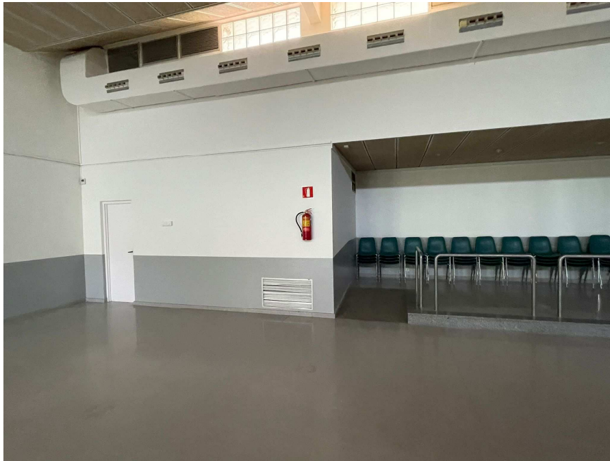
FOTO 13.-Ubicació extintors portàtils.
