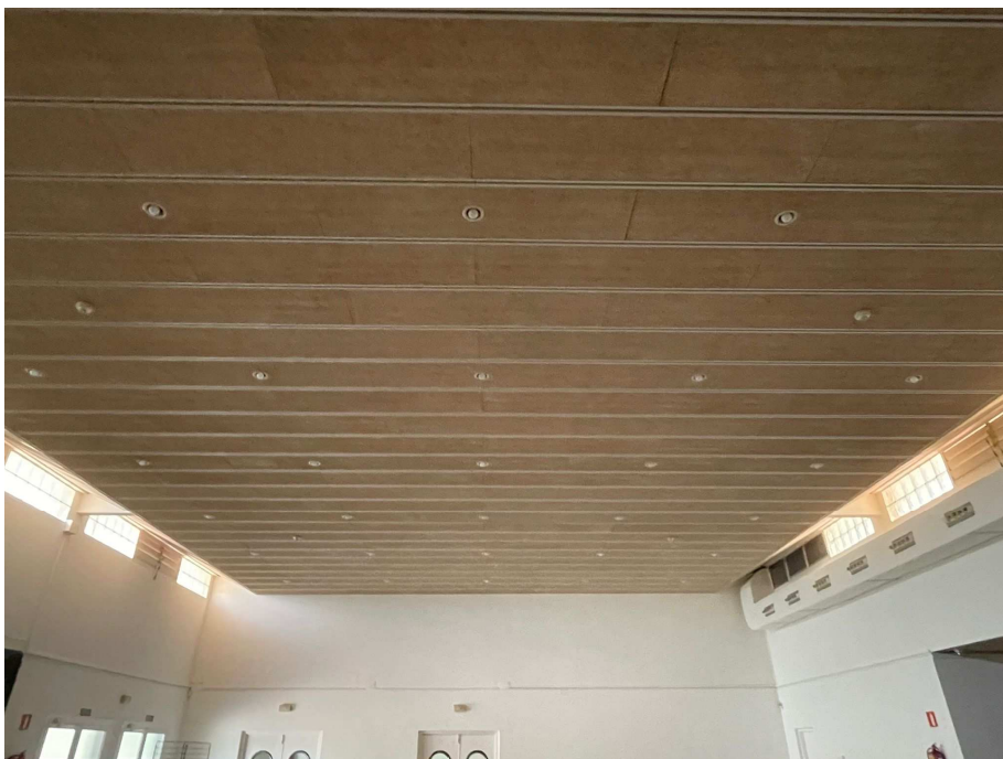
FOTO 18.-Fals sostre de la sala amb punts de llum i detecció d'incendis.
