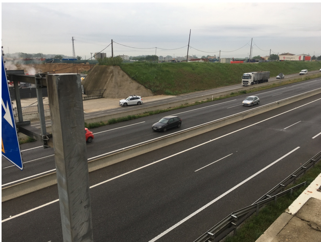
Sector 1: vista dels dos extrems de la futura passera sobre la A-2
