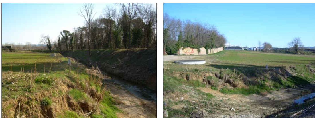
Figura 28. Punts amb inestabilitat del marge esquerre de la riera de Riudevila atenent a la verticalitat del marge, fora de l'àmbit de la Modificació puntual de les NS de Riudellots respecte l'ampliació de les instal·lacions de Frigorífics Costa Brava
