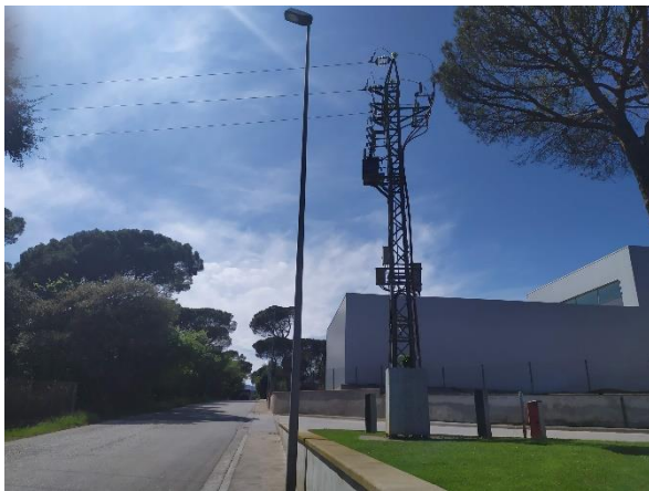
Imatge 2: Centre de Transformació Intempèrie GE38113 a desmuntar
