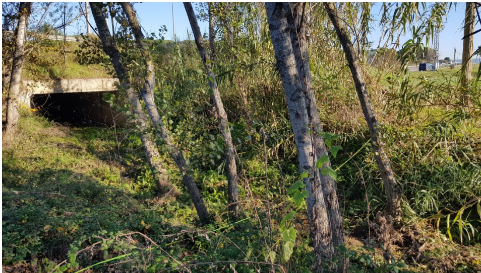
Imatge 1. Fotografia calaix prefabricat 3x2m
