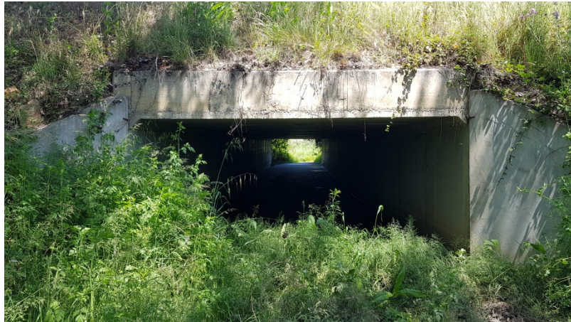
Imatge 3. Fotografia calaix prefabricat 4x2m
