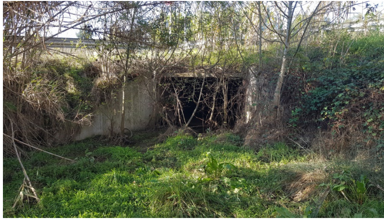
Imatge 5. Fotografia calaix prefabricat 3x1,3m
