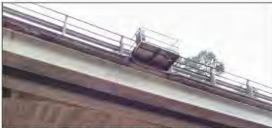
Imatge 2 Ubicació sensor de nivell tipus radar
