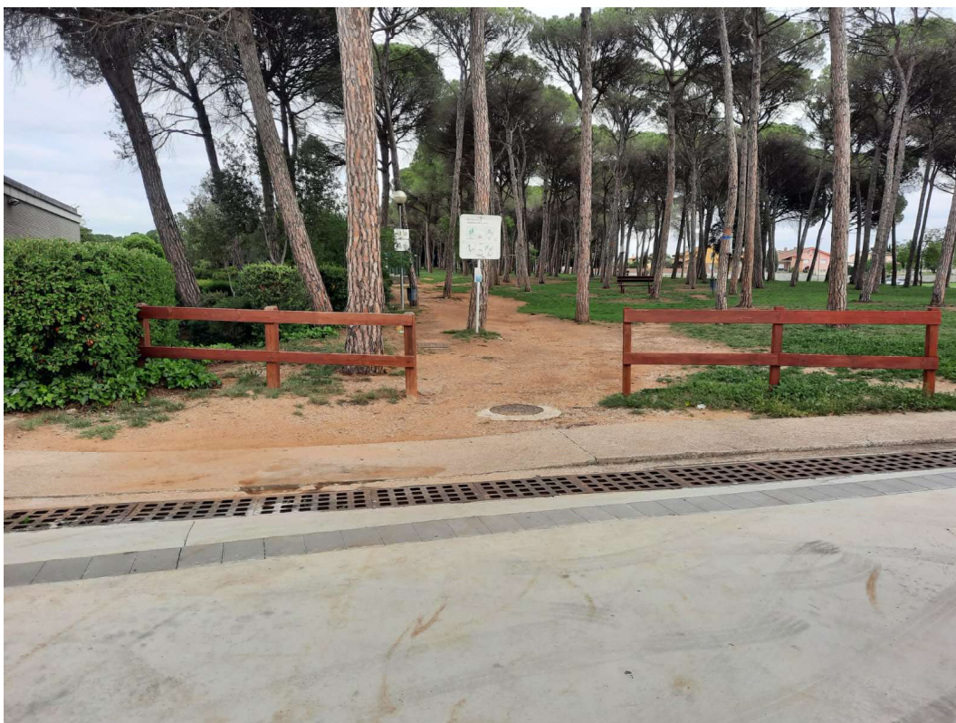
Entrada des dels accessos al pavelló municipal. Reixa interceptora i paviment a reparar per encontre amb el camí que es vol estabilitzar.
