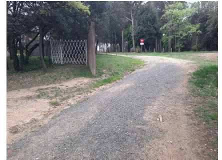
Fotografia estat actual cuneta recollida aigües provinents de la pujada del cementiri
