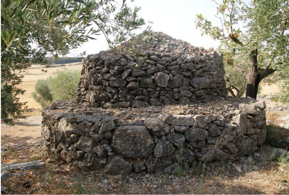
Vista del mur de coronament posterior, que presenta petites esllavissades
