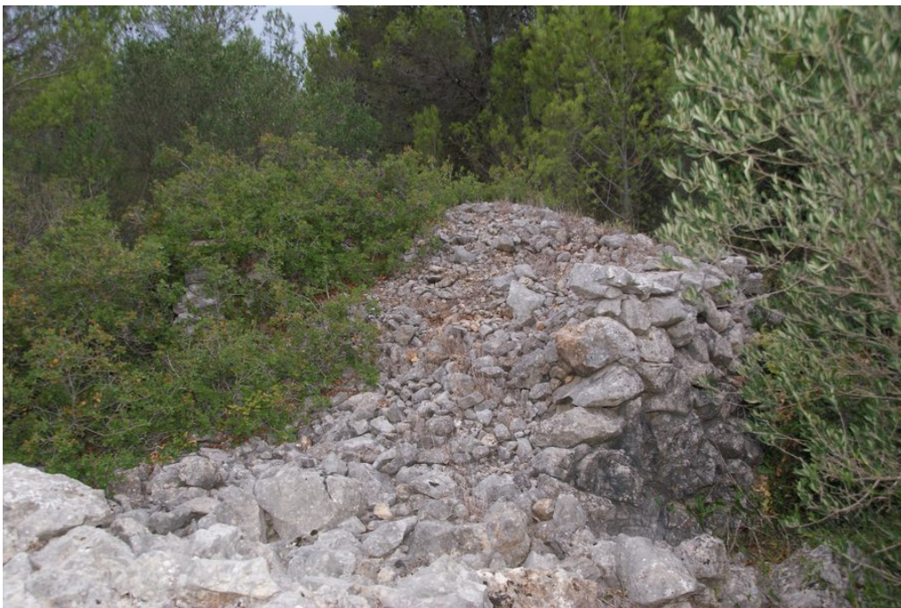
Vista on es pot apreciar la desfiguració general de l'element, just a la banda esquerra
