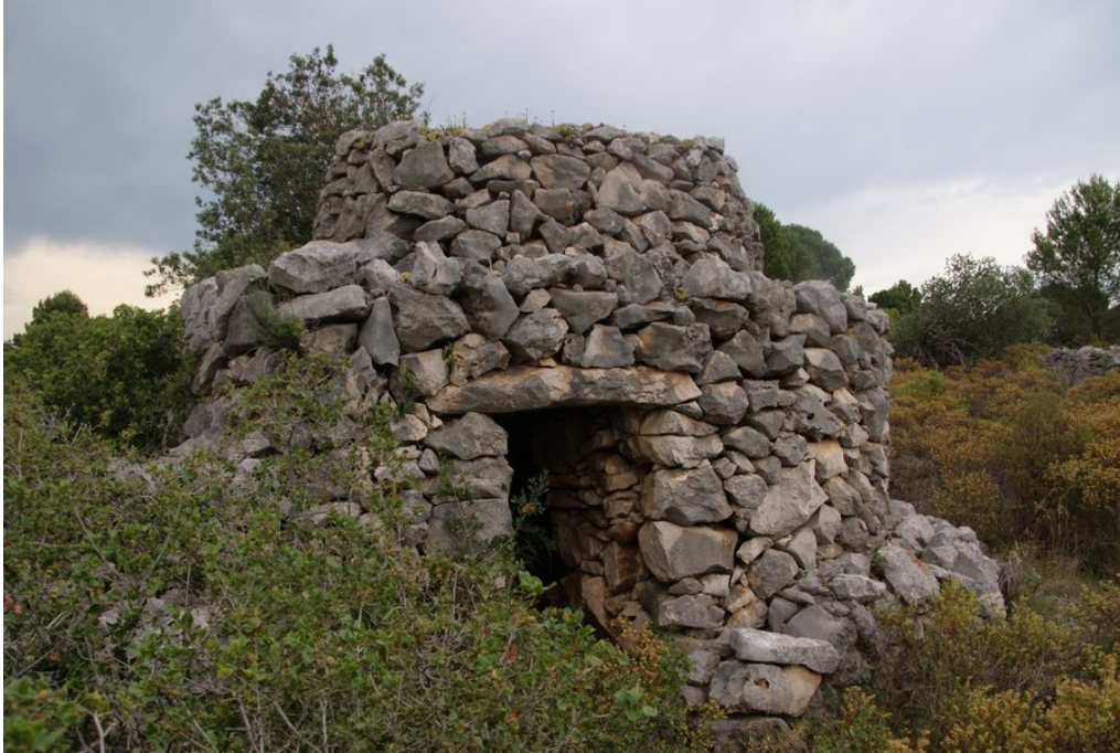
Vista de la façana principal, on es poden apreciar incidís de futurs esllavissaments.
