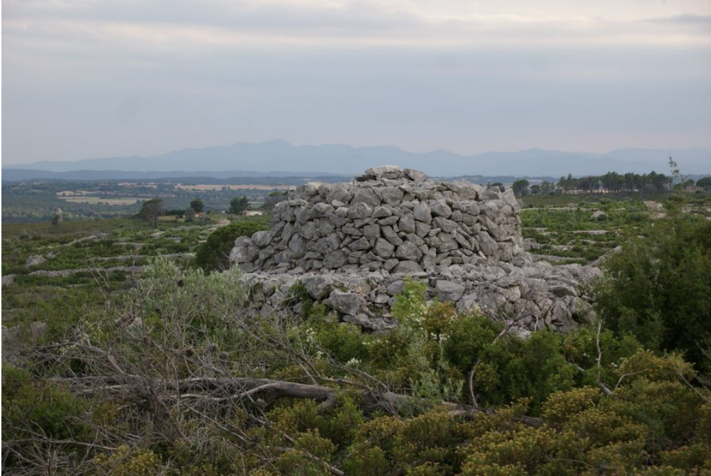
Vista de la posterior i l'afectació del coronament de la corona i la pèrdua del material de cobertura
