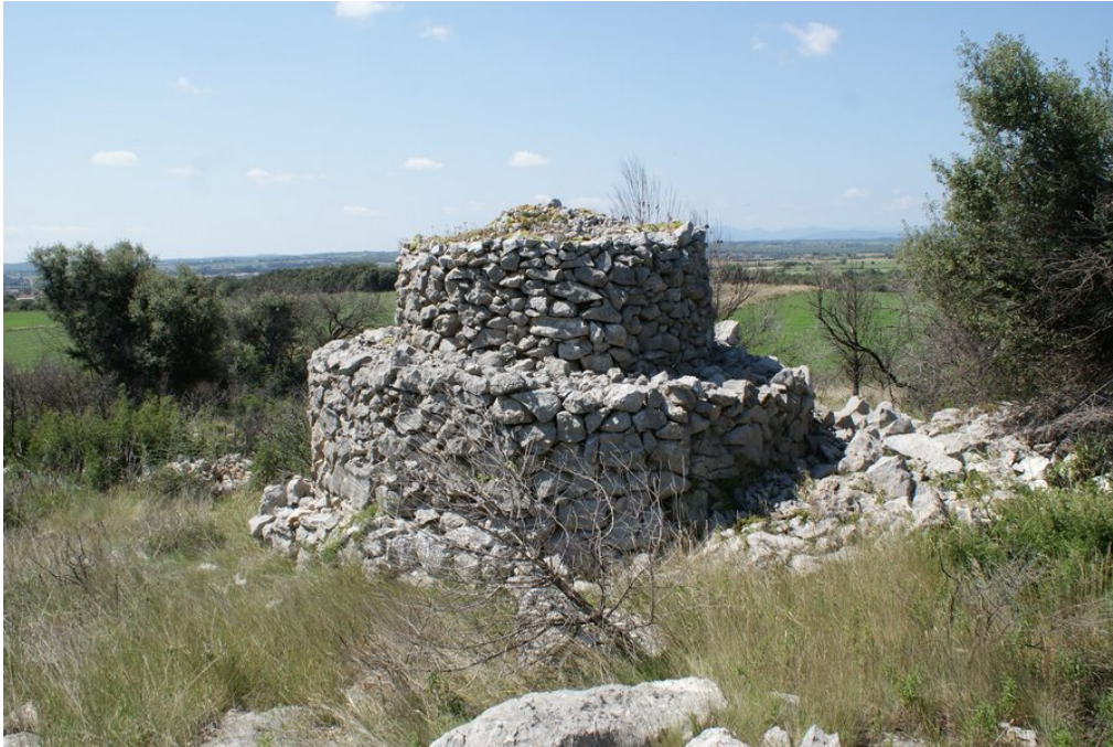
Vista de la banda posterior lateral dreta, on es poden apreciar els danys en el coronament del cos principal de la barraca.
