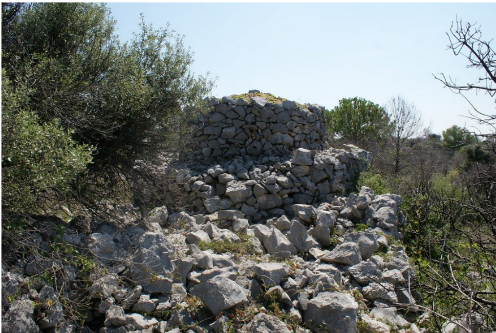
Vista de la part posterior, amb afectació dels murs de la barraca.
