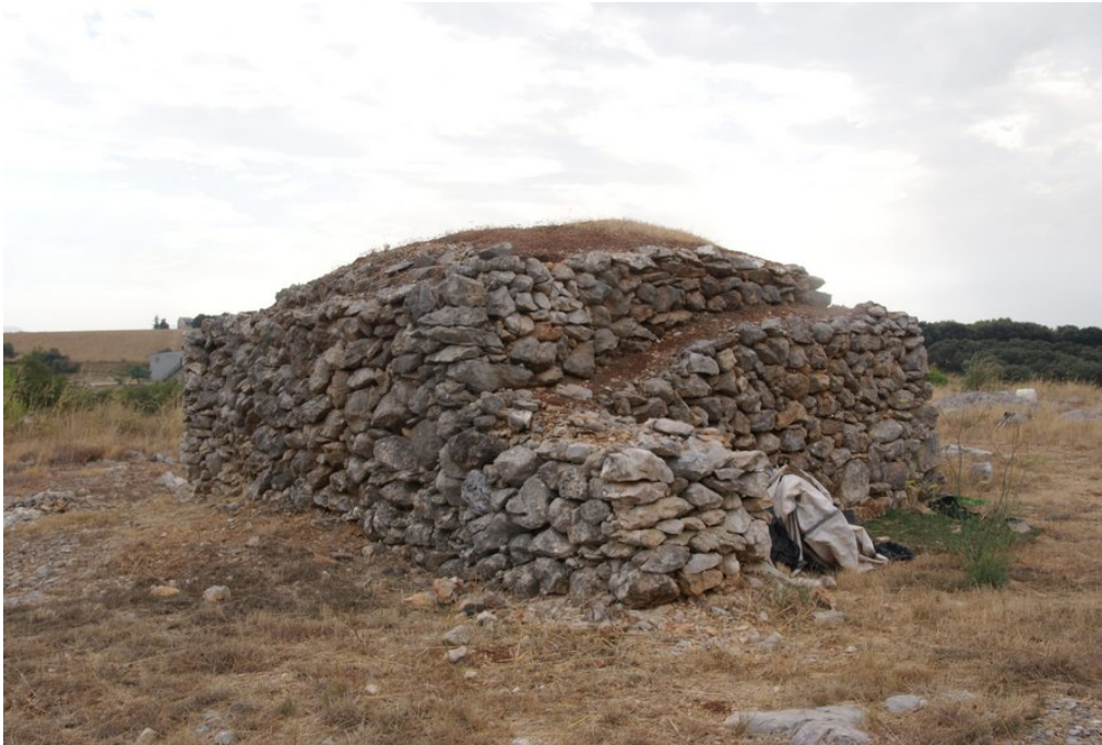
Vista del punt crític, on es pot apreciar l'esllavissament parcial del mur perimetral
