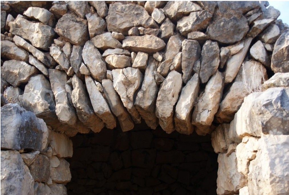
Detall de l'arc primitiu, amb signes evidents de desplaçament vertical
