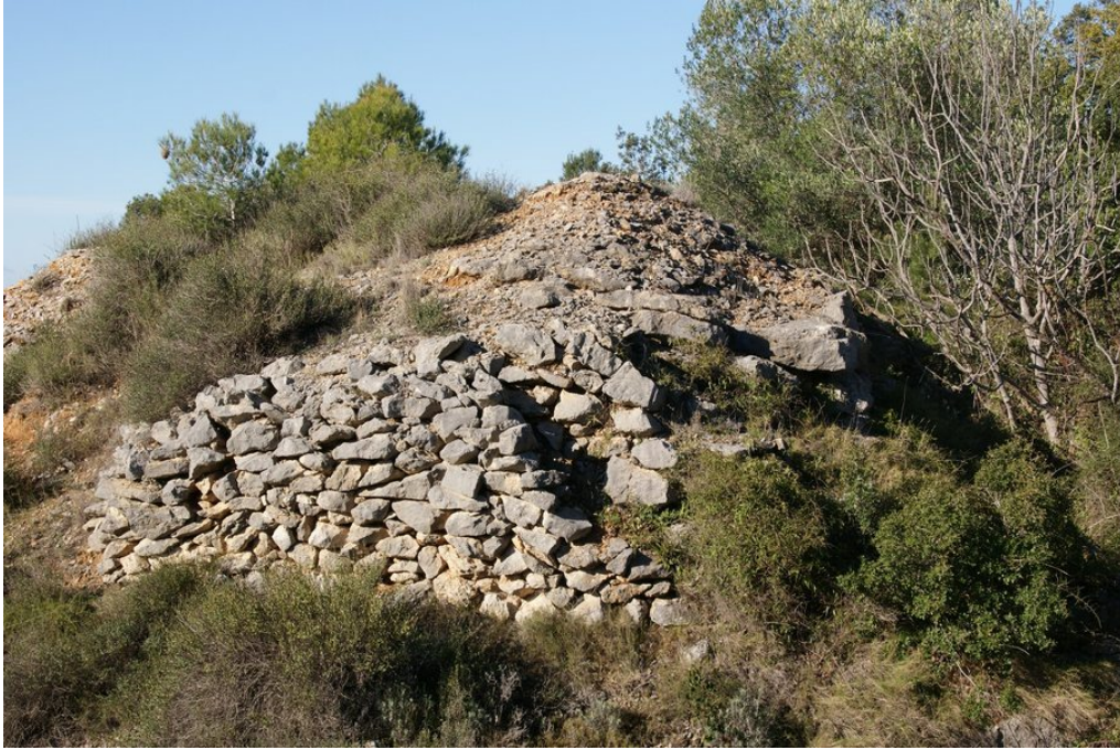
Vista dels esfondraments de la banda esquerra
