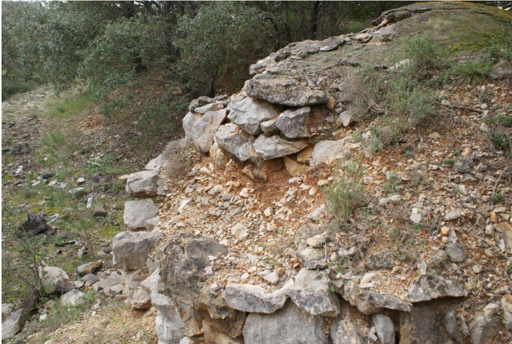
Vista dels desprendiments
