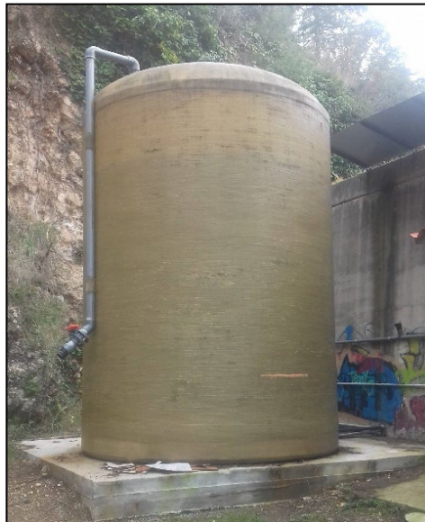
Dipòsit de Clorur Sòdic diluït existent en l'àmbit de la planta de tractament i detall de la boca de càrrega.
