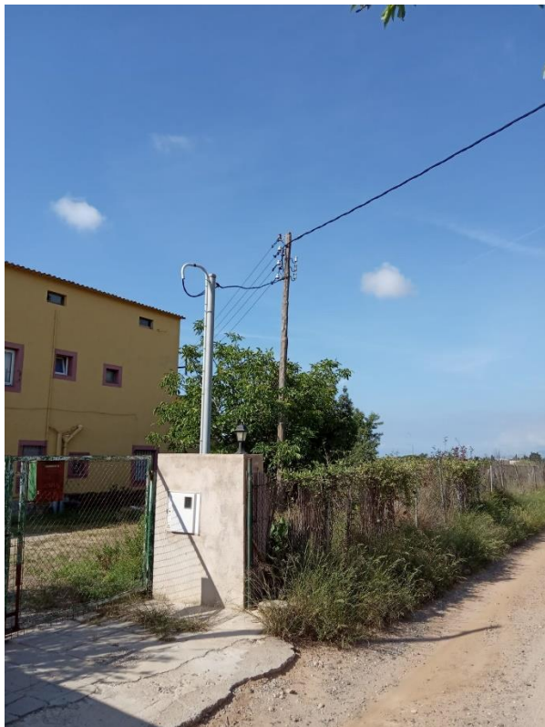
Foto11 . Suport PH-31, a substituir PM per PH 11/400
