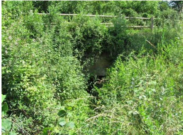
Estructura VI_01, torrent de la Vila, secció aigües amunt, en camí veïnal prop l'ermita de l'Àngel.
