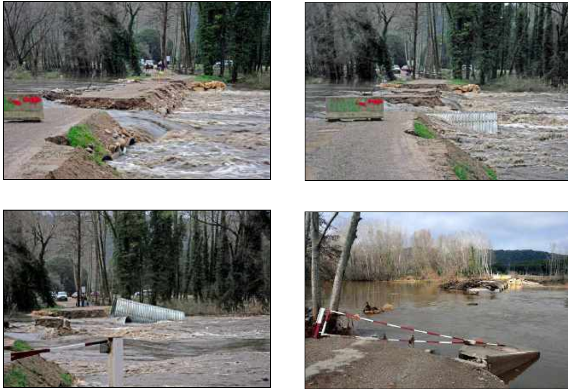
Vistes dels efectes erosius de les avingudes del riu Ter sobre l'estructura del gual existent.
