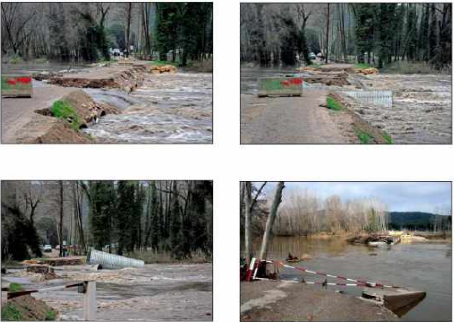
Vistes dels efectes erosius de les avingudes del riu Ter sobre l'estructura del gual existent.
