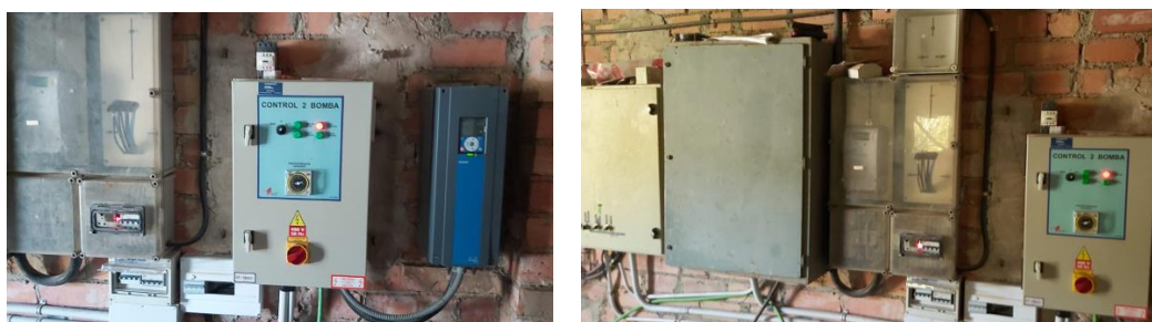
Figura 16. Quadres elèctrics dins la caseta.
