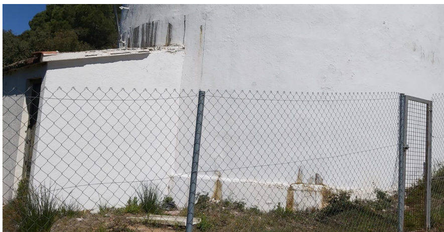
Figura 46. Filtracions en el dipòsit núm 1
