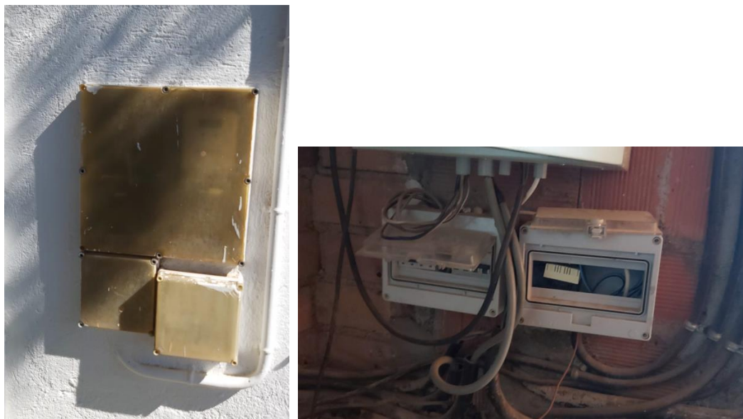
Figura 34. Escomesa elèctrica i quadre elèctric de protecció
