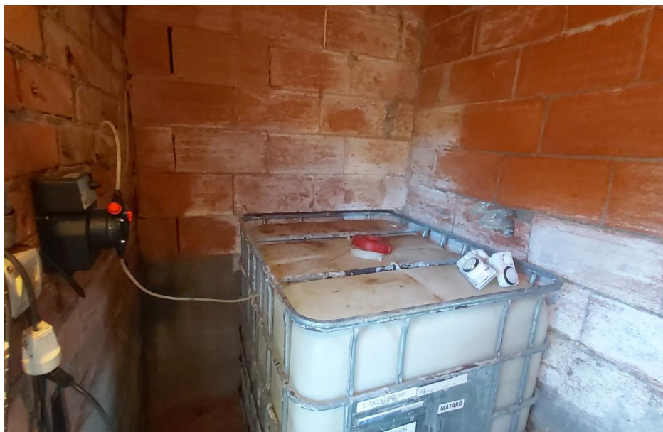
Figura 40. Dipòsit de Clor i Bomba de Clor.
