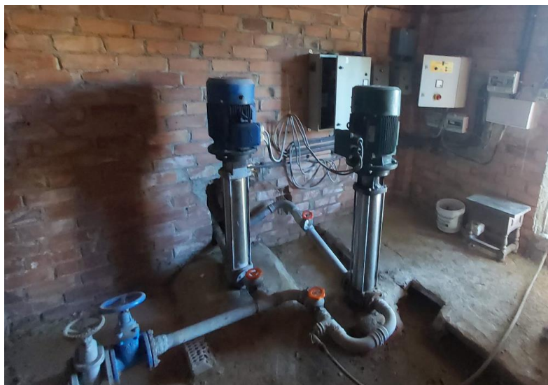
Figura 36. Imatge General Caseta Bombes i quadres elèctrics.
